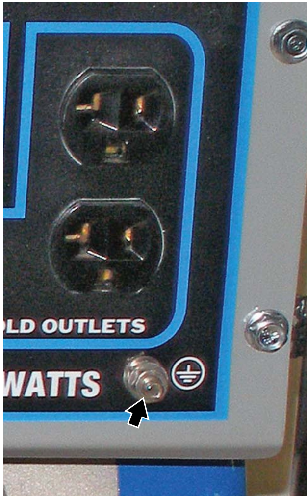
Figura 12 – Terminal de conexión a tierra del panel de control
